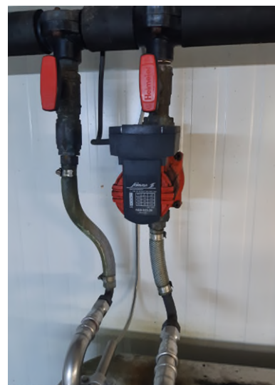
Pumpe Weintank (Kälte-/Wärmeverteilung)
