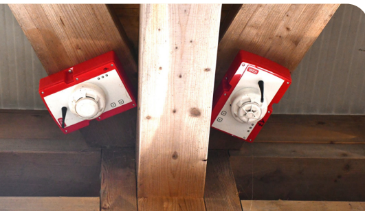
Drahtlose, staubgeschützte Rauchmelder und Wärmemelders garantieren eine frühzeitige Warnung im Brandfall. Diese können in bestehenden Stallanlagen nachträglich ohne weitere bauliche Massnahmen eingebaut werden. (Bild: BUL)
