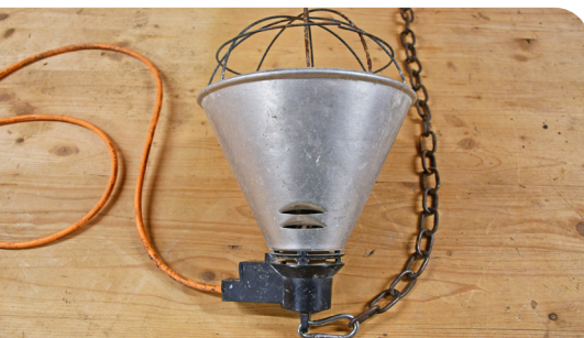
Der Zustand der Wärmelampe, der Kette und des Befestigungspunkts an der Decke ist regelmässig zu prüfen. (Bild: BUL)
