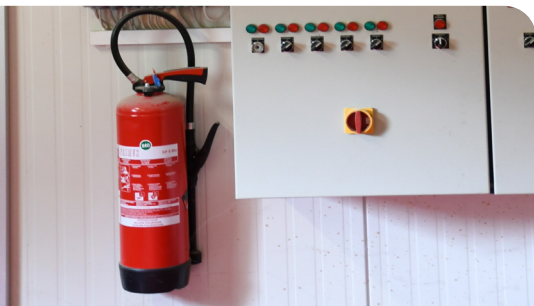
Löschmittel müssen gut sichtbar und zugänglich sein. (Bild: BUL)
