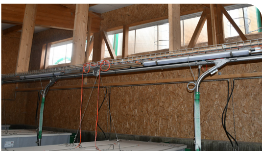
Sauber und übersichtlich verbaute Leitungen erleichtern die Sichtkontrolle bei elektrischen Installationen. (Bild: BUL)
