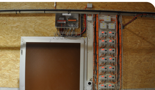
Regelmässige Sichtkontrollen der technischen Einrichtungen und Unterhalt nach Herstellerangaben minimieren Brände durch technische Störungen. (Bild: BUL)
