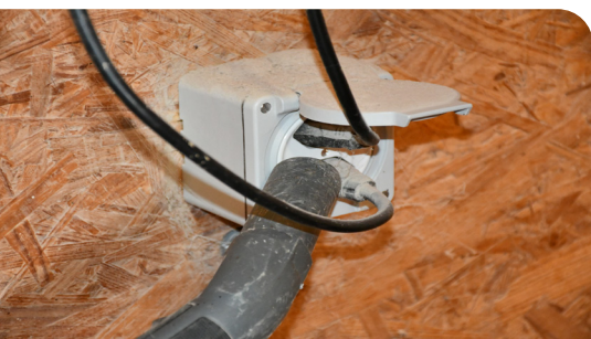
Mit dem Staubsauger Steckdosen regelmässig vom Staub befreien. (Bild: BUL)
